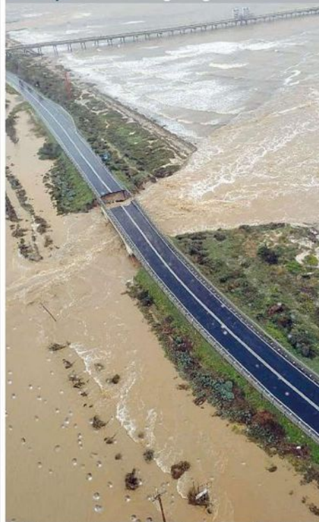
Cagliari, il tratto della statale 195 verso Capoterra e Pula, dove la piena ha distrutto la strada
