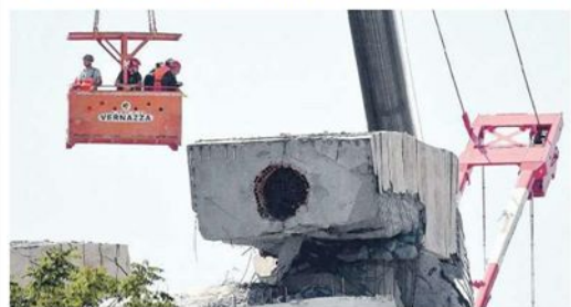
I tecnici al lavoro per valutare la situazione di ciò che resta del ponte di Genova (Foto ANSA)
